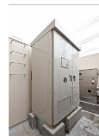
蓄電池システム(30kWh)
