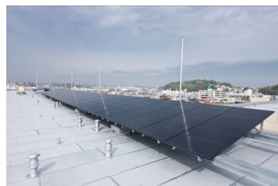
太陽光発電システム(20kW)
