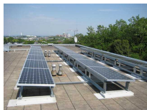
図3 太陽光パネル
