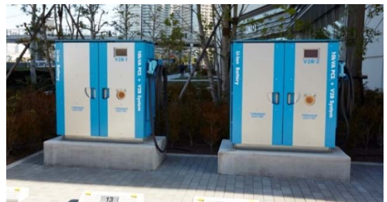
蓄電池内蔵型電気自動車充電機
