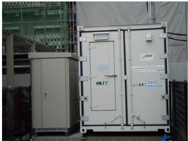
図(2)-2 タウン用蓄電池システム・門司地区設置状況
