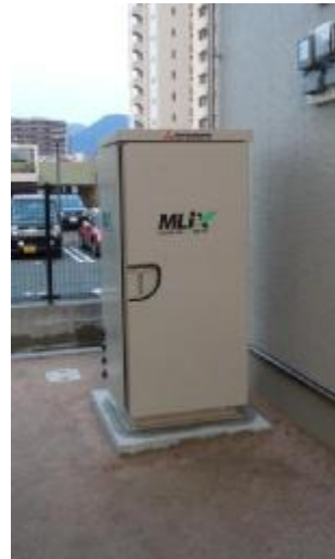
図(1)-3 戸建住宅用蓄電池システム・ 門司地区設置状況
