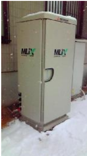
図(1)-2 戸建住宅用蓄電池システム・ つくば試験場設置状況
