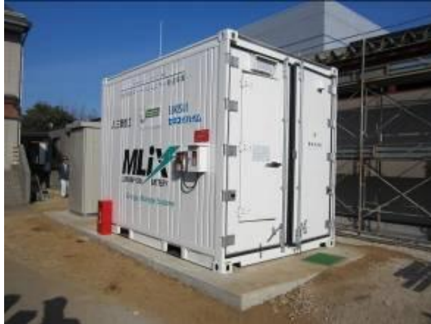
図(1)-4 タウン用蓄電池システム・茨城県つくば市積水化学工業試験場設置状況
