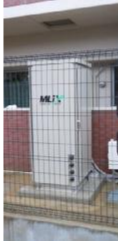
図(1)-1 戸建住宅用蓄電池システム・北九州東田地区設置状況
