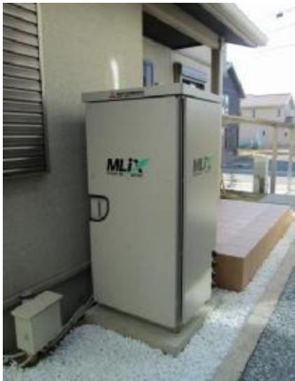
図(2)-1 戸建住宅用蓄電池システム・ 門司地区設置状況
