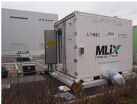
図(1) 戸建住宅用蓄電池システム・北九州東田地区設置状況
