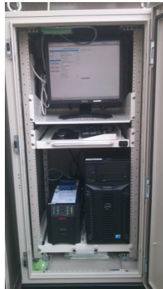
いのちのたび博物館 10kW 蓄電地用 蓄電池運用管理システム
