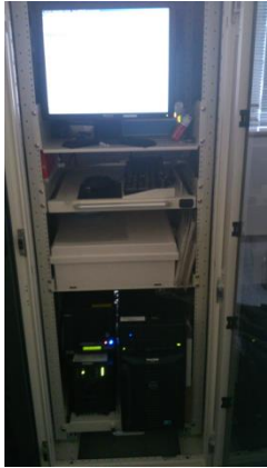
ヒューマンメディア創造センター 10kW 蓄電地用 蓄電池運用管理システム
