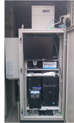
いのちのたび博物館 100kW 蓄電池用 蓄電池運用管理システム
