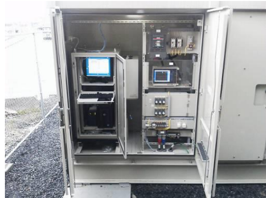
300kW 蓄電地用 蓄電池運用管理システム (スレーブ側)
