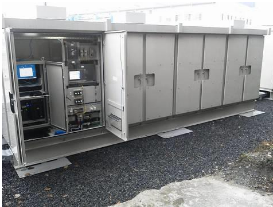
300kW 蓄電地用 蓄電池運用管理システム (マスター側)
