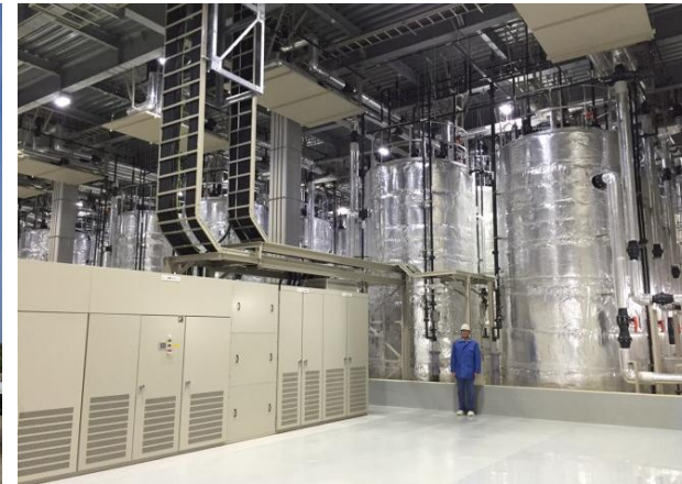
＜建屋内の電解液タンク＞
